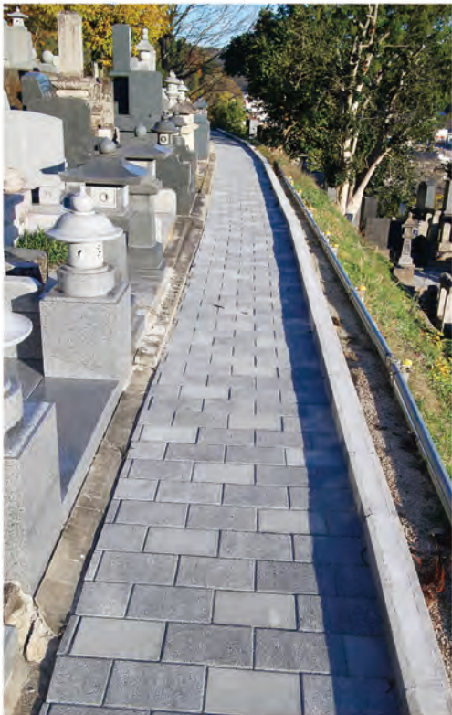
▲ 浸透性のインターロッキング通路
